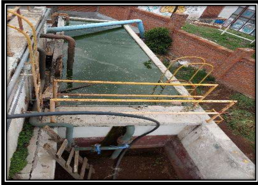
Ilustración 43. Digestor de lodos
