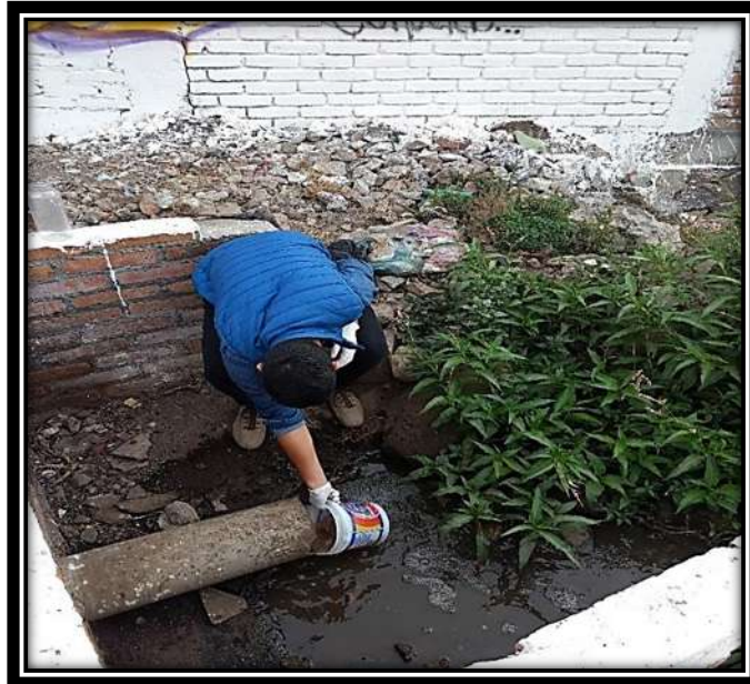
Ilustración 52. Tubería de descarga del efluente tratado (EAST)
