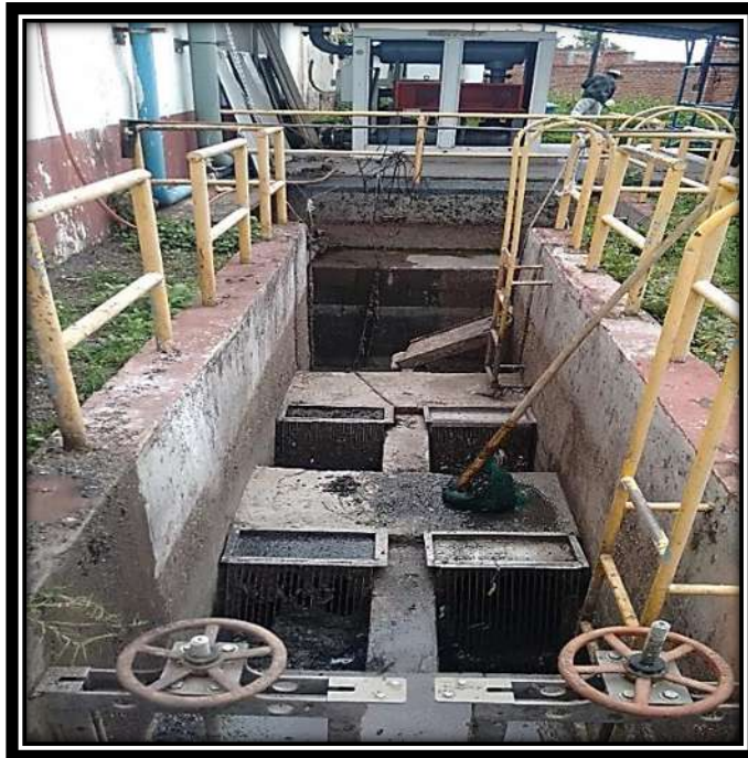
Ilustración 37. Estado actual de las rejillas y desarenador de la PTAR (EAST)
