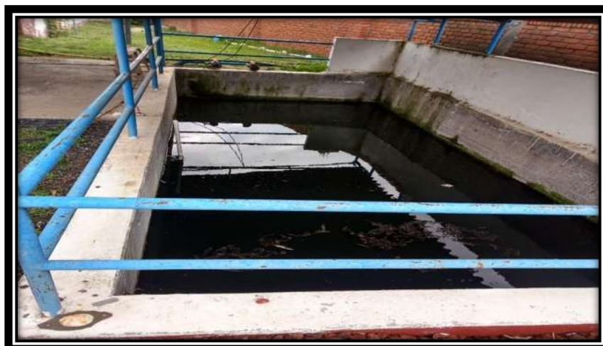
Ilustración 44 Estado actual del tanque homogeneizador, se encuentra fuera de operación.
