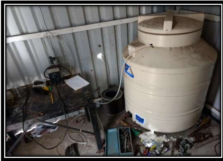
Ilustración 48. Estado actual del sistema de cloración
