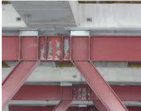
Figura 1.2 Ejemplo de daño en eslabón para la reparación estética (MR-1). [Foto obtenida de Gulec et al. (2011)]
