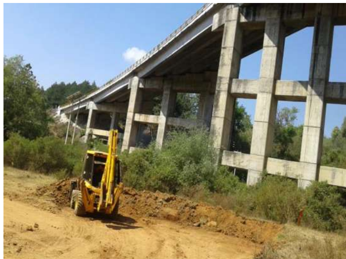
IMAGEN 15. DESPALME DE ZAPATA APOYO 3, FUENTE: ALEJANDRO CORTÉS CRUZ
