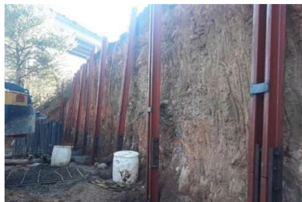
IMAGEN 29, PERFILES EN EXCAVACION DE PILOTES PARA TABLA ESTACADO PILA DOS PREVIO A SER COLADOS, FUENTE: ALEJANDRO CORTÉS CRUZ
