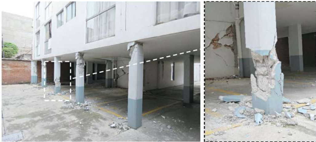
Figura 1.4 Edificio con planta baja débil que presenta concentración de daño severo en columnas del primer nivel (foto de: Pablo Heresi)
