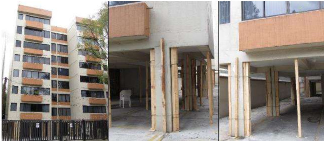
Figura 1.5 Edificio con planta baja débil que sufrió concentración de daño moderado en las columnas del primer nivel debido al sismo del 19 de septiembre de 2017 (fotos de: Jorge Ruiz-García)
