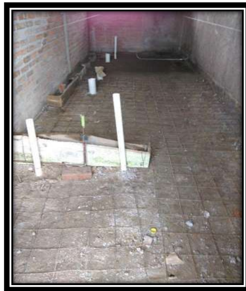
Figura V.63 tubería de PVC de 2 pulgadas para mingitorios y vertederos. Fuente: Propia
