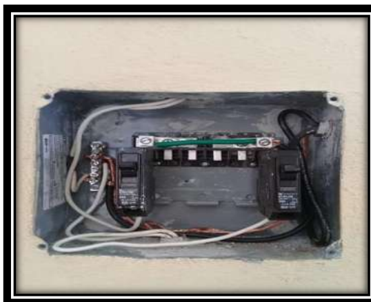
Figura V.54 tablero de control. Fuente: propia
