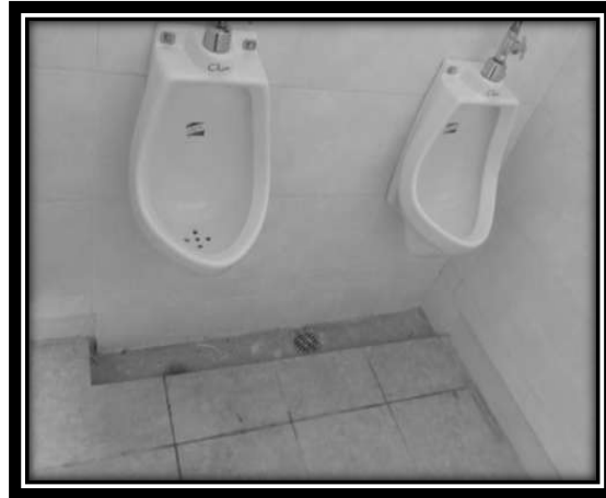
Figuran V.70 colocación de mingitorios. Fuente: Propia
