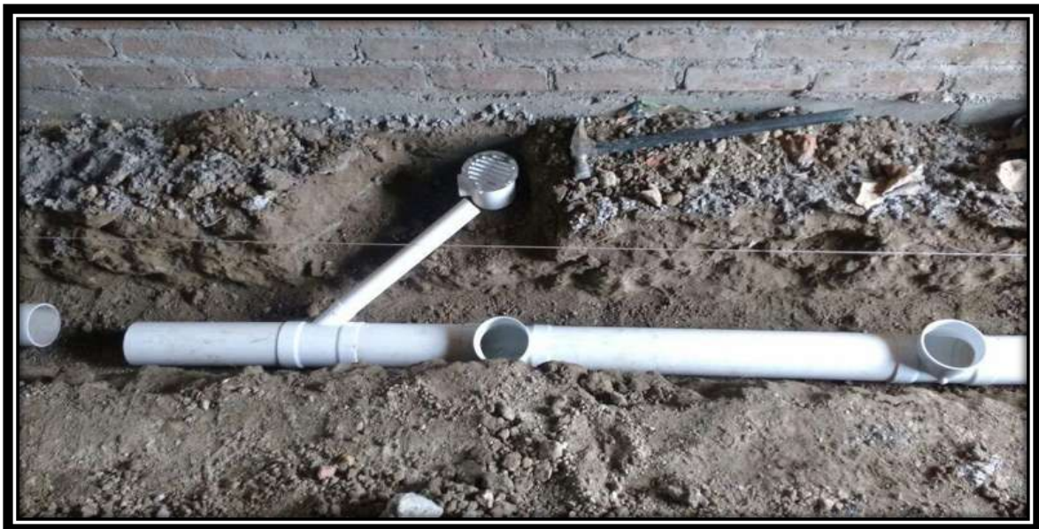
Figura V.61 Tubería PVC de 4 pulgadas de diámetro con conexiones T para recibir wc y tipo Y con reducción para 2" para recibir la coladera. Fuente: Propia
