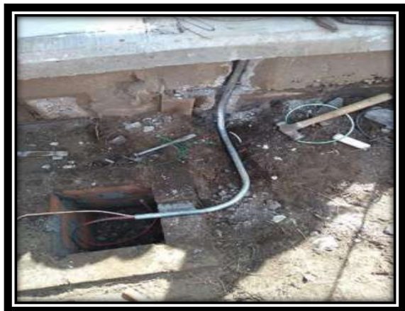
Figura V.53 registro eléctrico. Fuente: propia
