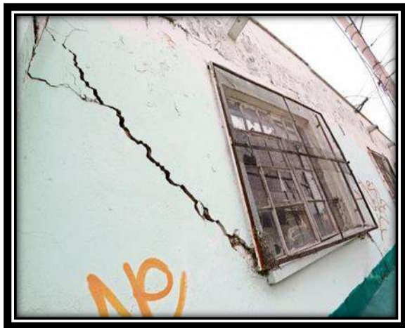
Figura I.5 Daño estructural en muro lateral de aula. Fuente: Propia
