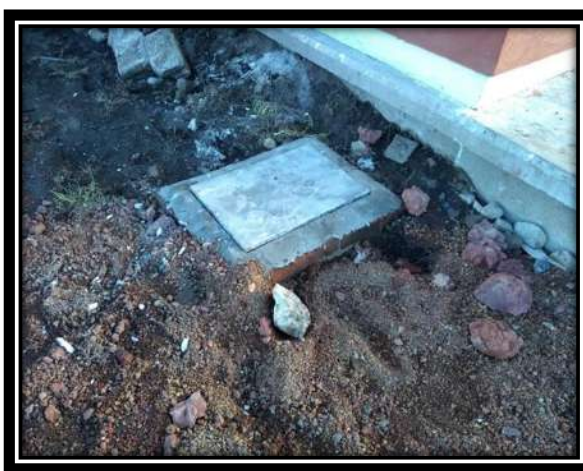
Figura V.49 registro eléctrico terminado. Fuente: propia
