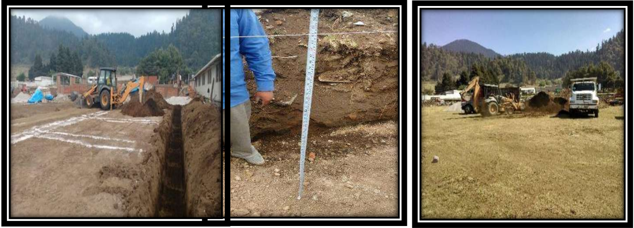
Figura V.17, V.18 y V.19 Excavación con maquinaria (retroexcavadora CASE 416) verificación de alturas y retiro de material producto de la excavación con camiones de volteo con capacidad de 7m 3 . Fuente: Propia.
