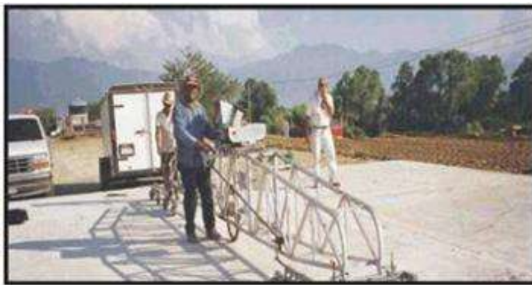
Fig. N°51.- Equipo para medición de calidad de la superficie del pavimento. Perfilografo tipo California.
