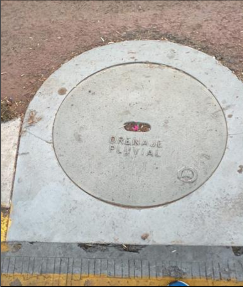
Ilustración 44. Tapa el drenaje pluvial.
