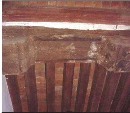
Figura 38. Gualdra del patio principal en mal estado.
