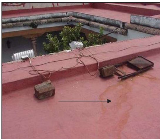
Figura 54. Azotea con mancha de humedad.
