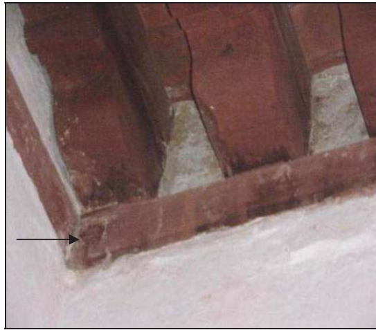
Figura 36. Vigas de cerramiento con humedad e insectos.
