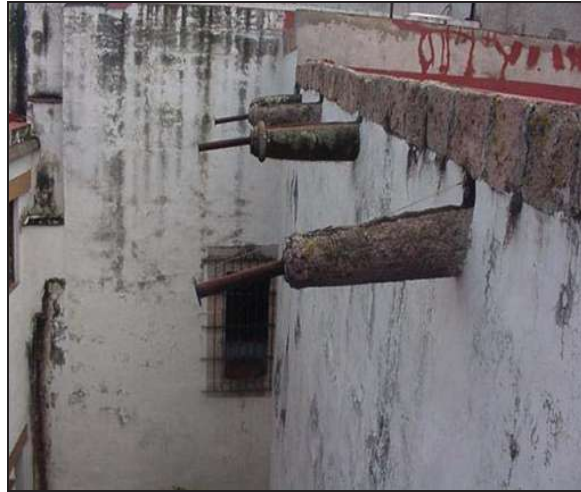
Figura 56. Muros con humedad y grietas.
