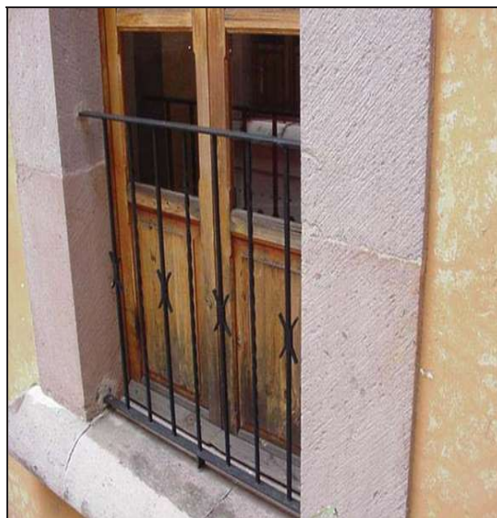
Figura 47. Puerta con deterioro por agentes climáticos.
