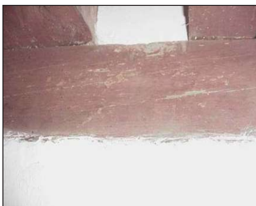
Figura 17. Vigas de cerramiento con perforaciones de insectos.
