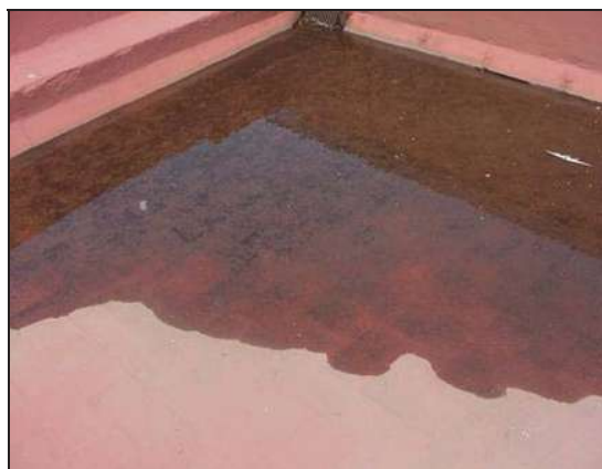
Figura 58. Acumulación de agua en coladeras.
