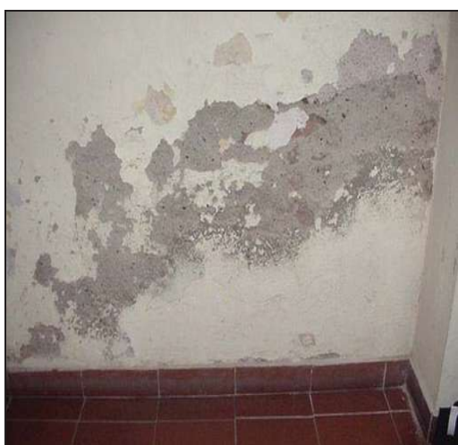
Figura 59. Desprendimiento de capas de los muros Casa Anexa.
