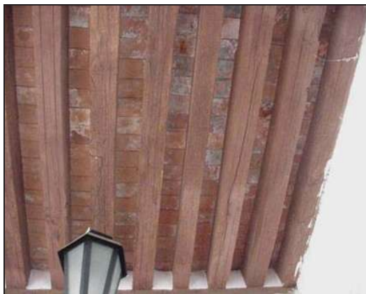
Figura 15. Exceso de humedad en las vigas.
