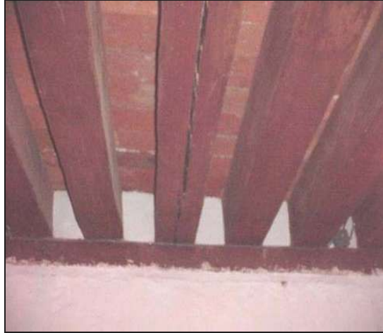
Figura 18. Viga con grietas (grandes)
