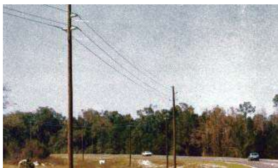
Figura. 9. Postes en redes eléctricas
