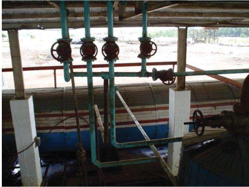
FIGURA No. 5 tubería y válvulas para la distribución de la creosota en los diferentes tanques, Impregnadora Las Vigas de Rafael Ramírez, Ver.
