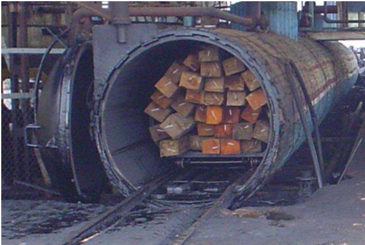
FIGURA No.1 Boca puerta de cilindro de tratamiento con cubierta térmica, capacidad individual de 25 m 3 , Impregnadora Las Vigas de Rafael Ramírez, Ver.
