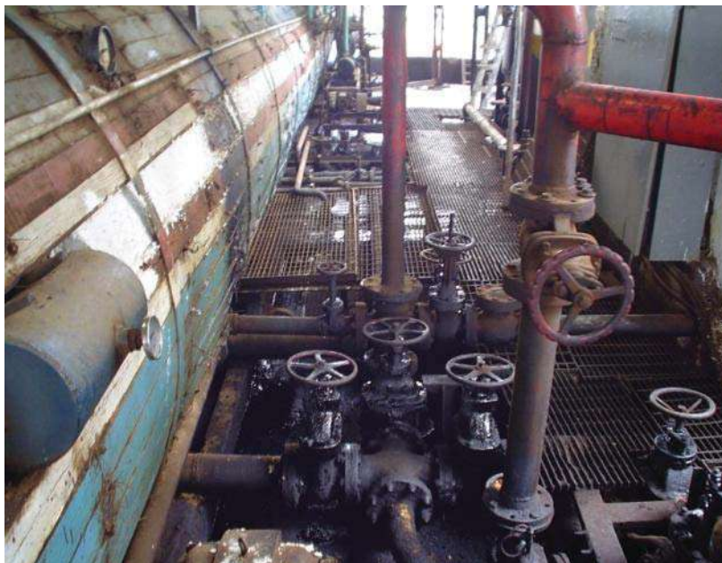
FIGURA No. 3 Vista parcial del área de impregnación de una planta de tratamiento de maderas, Impregnadora Las Vigas de Rafael Ramírez, Ver.
