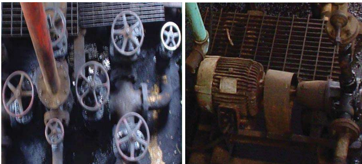
FIGURA No. 4 Conjunto de válvulas y equipo para el traslado y movilidad de líquidos impregnantes de maderas, Impregnadora Las Vigas de Rafael Ramírez, Ver.
