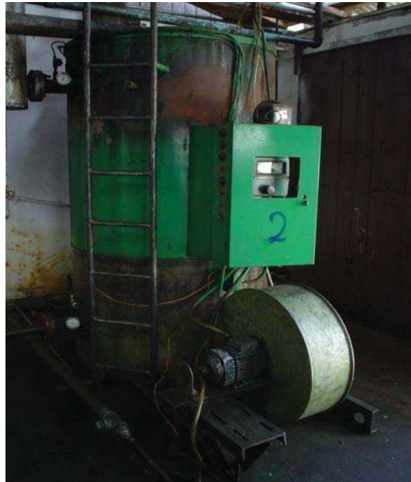
FIGURA No. 6 Ciclonik tiene las funciones de una caldera con la capacidad de calentar aceite térmico de alta temperatura. Las Vigas de Rafael Ramírez, Ver.
