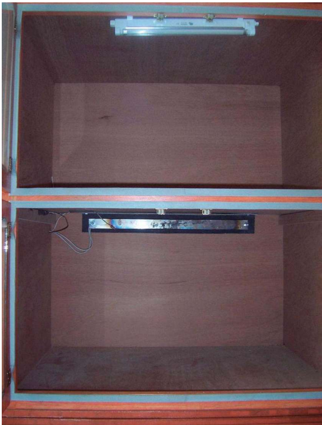
Figura 8. Instalación de la resistencia y lámpara para cada una de las cajas de madera.
