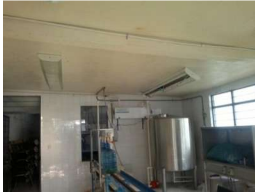
Figura 15. Daños al tendido Eléctrico.
