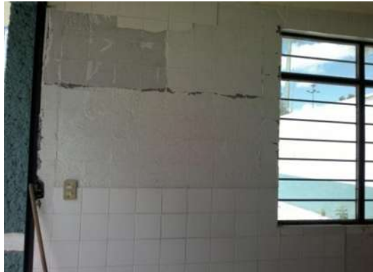
Figura 16. Daños en el Edificio.
