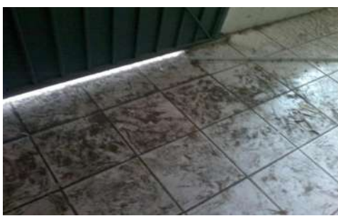
Figura 20. Uso Inadecuado de las Instalaciones (II).
