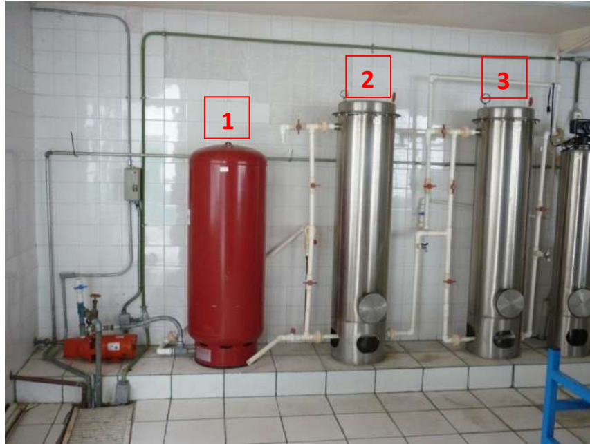
Figura 2. (1) Tanque Hidroneumático, (2) Filtro de Lecho Profundo y (3) Filtro de Carbón Activado.
