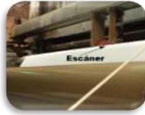
Figura 4. 3 Escáner de monitoreo y registro de la humedad en el papel.
