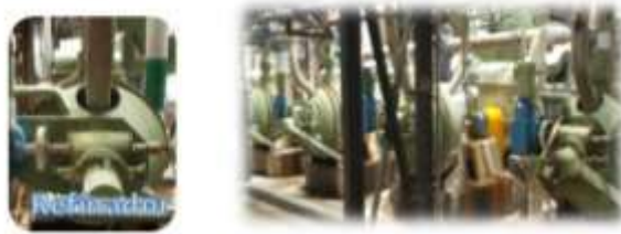
Figura 2.3 Tren de refinadores para celulosa.
