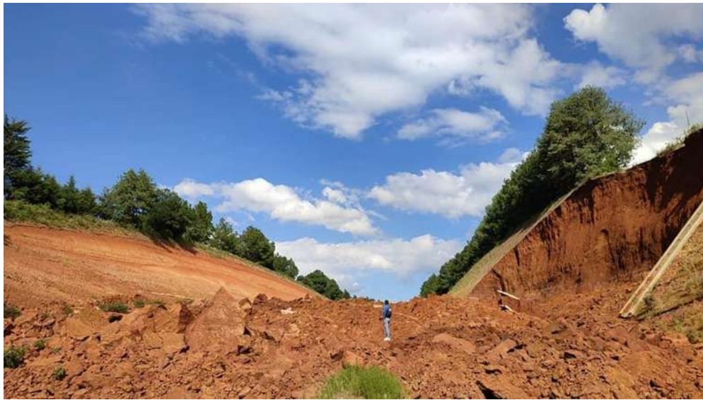
Figura 12: Colapso del talud año 2021
