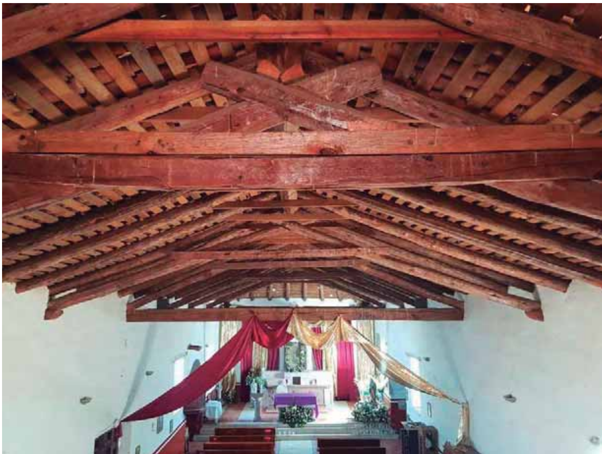
Figura 62. Vista interior de la cubierta. Fotografía tomada por Saleta Lizbeth Vargas Viveros.
