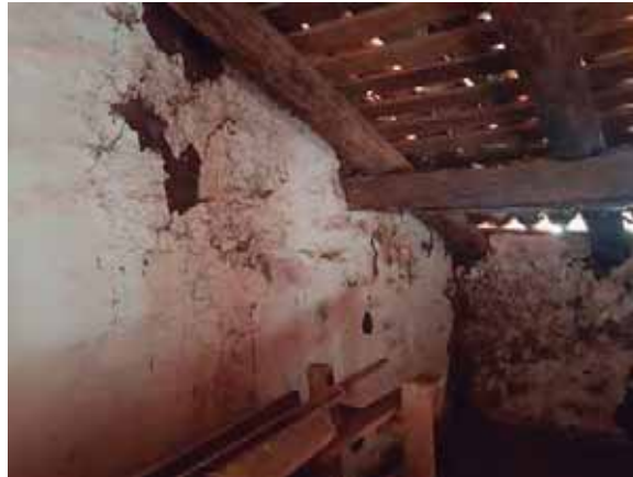
Figura 79. Deterioro en coro. Fotografía tomada por Saleta Lizbeth Vargas Viveros.
