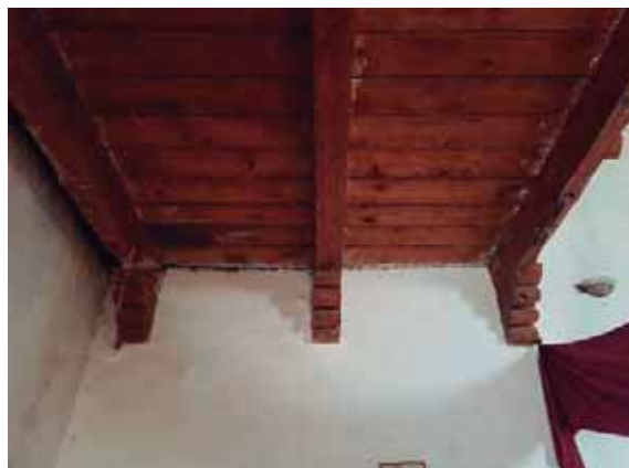
Figura 78. Deterioro en entrepiso del coro. Fotografía tomada por Saleta Lizbeth Vargas Viveros.
