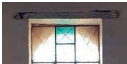
Figura 82. Apolillamiento en cerramiento de vano. Fotografía tomada por Saleta Lizbeth Vargas Viveros.
