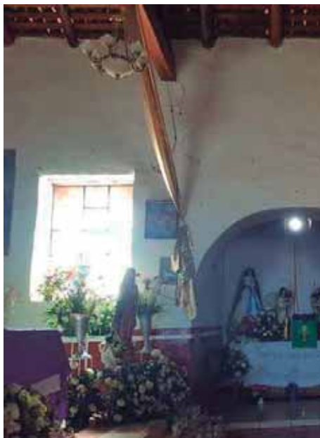
Figura 81. Fisura en recubrimiento de la nave. Fotografía tomada por Saleta Lizbeth Vargas Viveros.
