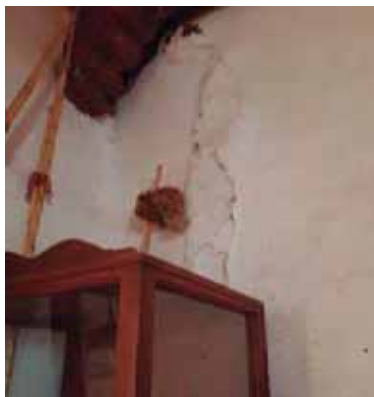
Figura 77. Fisura en sotocoro. Fotografía tomada por Saleta Lizbeth Vargas Viveros.
