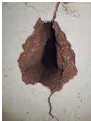
Figura 80. Oquedad en muro. Fotografía tomada por Saleta Lizbeth Vargas Viveros.
