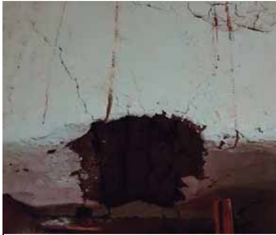
Figura 85. Deterioro en muros de sacristía. Fotografía tomada por Saleta Lizbeth Vargas Viveros.
