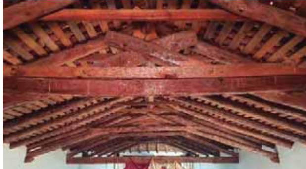
Figura 83. Deterioros en estructura de madera de la cubierta. Fotografía tomada por Saleta Lizbeth Vargas Viveros.
