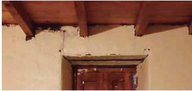
Figura 87. Deterioro en recámara. Fotografía tomada por Saleta Lizbeth Vargas Viveros.
