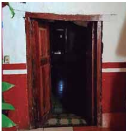
Figura 84. Alabeo en cerramiento de puerta. Fotografía tomada por Saleta Lizbeth Vargas Viveros.
