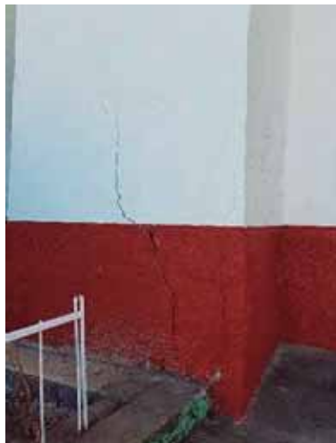
Figura 76. Grieta en fachada norte. Fotografía tomada por Saleta Lizbeth Vargas Viveros.
