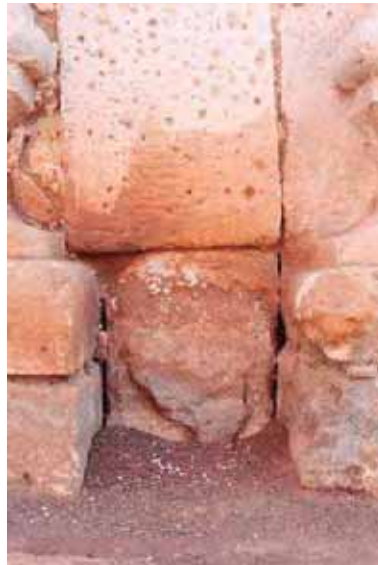
Figura 74. Deterioro en portada de acceso. Fotografía tomada por Ana Cecilia Martínez Cruz.
