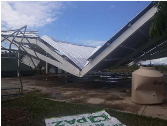
a) Daños en techo laminado
