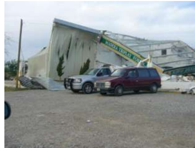
b) Daños producidos en Techos
