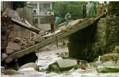
c) Puente derribado por flujo de agua ( http://www.panoramadelpacifico.com/a-23-anos-del-huracan-paulina/ )
