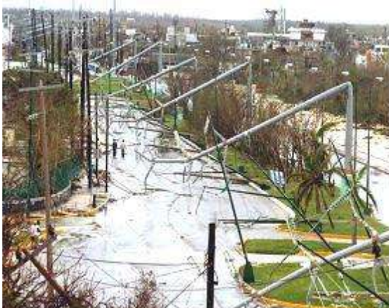
a) Daños a infraestructura eléctrica
