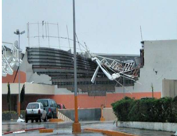
b) Muro de estructura afectado
