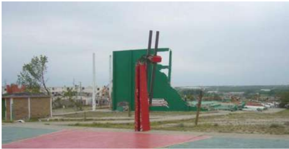
a) Daños en muros
