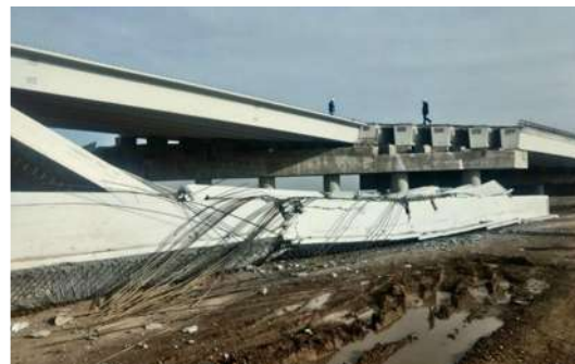
d) Puente colapsado
