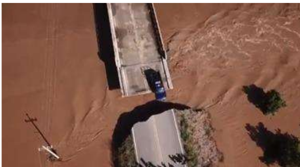
c) Socavación en puente
