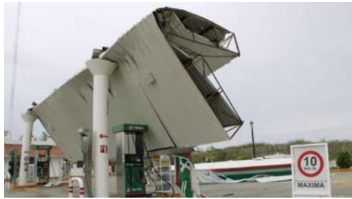
a) Techo de lámina dañada
