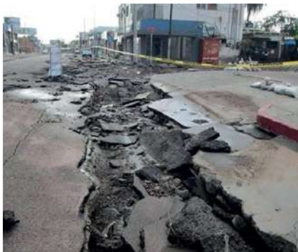
a) Agrietamiento de carpeta asfáltica
