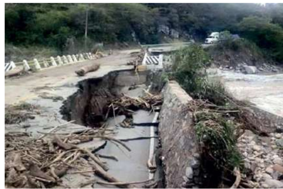
b) Daños en Aquila Michoacán
