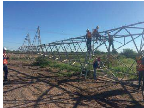
b) Afectaciones en línea de alta tensión
