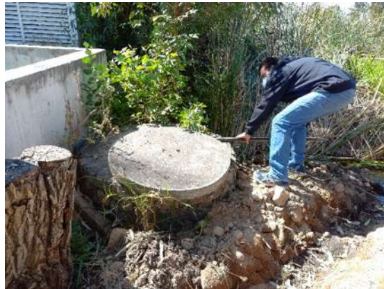
Figura 15. pozo de visita común en la entrada a la planta
