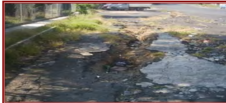
Desgaste por el Agua Pluvial; 42,Imagen 73
