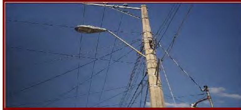
Postes de concreto armado para la línea eléctrica 33 Imagen 59
