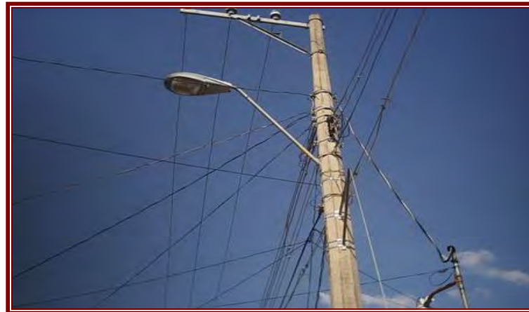
Imagen de poste de media tensión y cables de la instalación eléctrica; 54,Imagen 84
