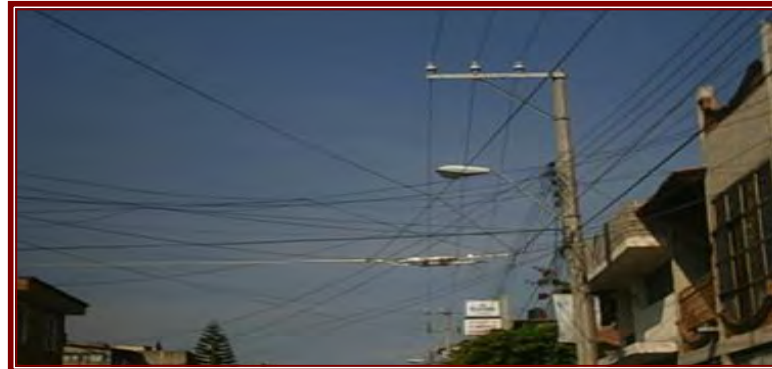
Cableado de Energía Eléctrica, Afecta la Imagen ; 44,Imagen 75
