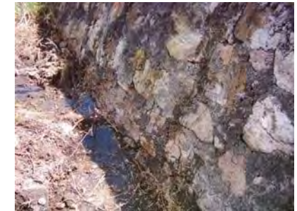
FOTO No. 4 Fuga en tanque almacenamiento colonia Cuauhtemoc
