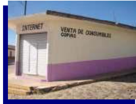
Imagen 128.- Remodelación incorrecta, manzana b.
