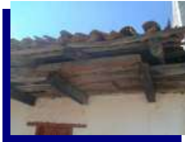
Imagen 124.- Tejas deterioradas, manzana b.
