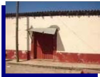
Imagen 110.- Falta de mantenimiento manzana c.
