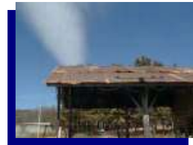
Imagen 123.- Desgaste natural en techos, manzana e.
