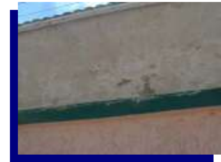
Imagen 105.- Salitre en muros manzana c.
