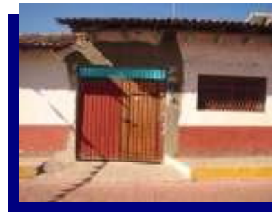
Imagen 111.- Falta de mantenimiento manzana a.
