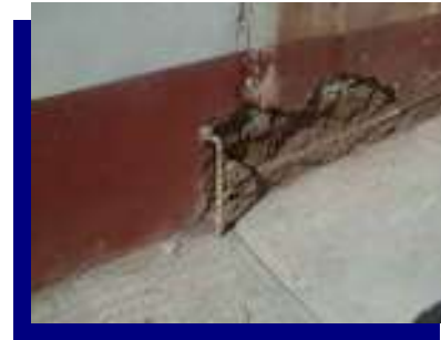
Imagen 116.- Deterioro en muros por fuga de agua, manzana c.
