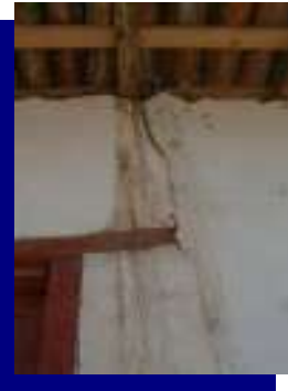
Imagen 103.- Filtración de agua pluvial manzana f.
