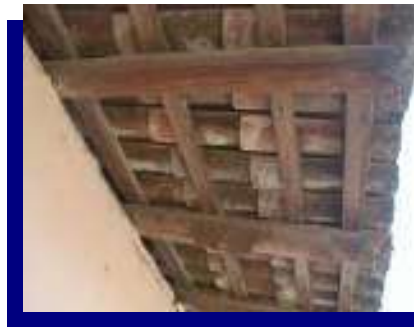
Imagen 104.- Salitre por filtración de agua en tejas manzana c.
