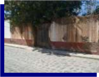
Imagen 107.- Deterioro en muros manzana c.
