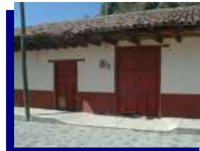
Imagen 118.- Deterioro en portones, manzana b.
