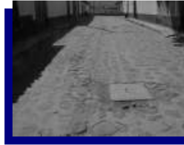
Imagen 101.- Deterioro de pavimentos calle Cervantes entre manzana c y f.
