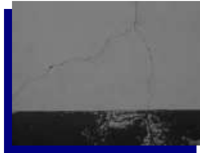
Imagen 115.- Deterioro en la pintura manzana c.
