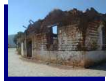
Imagen 108.- Deterioro en muros manzana c.
