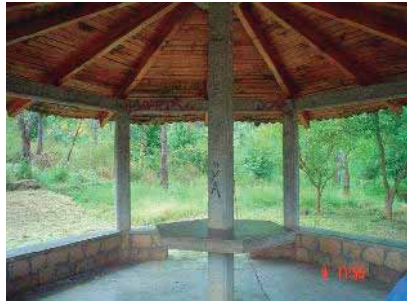
FOT.-8 En esta foto vemos que este espacio también que cuenta con cenadores, algunos de los cuales presentan rayones.
