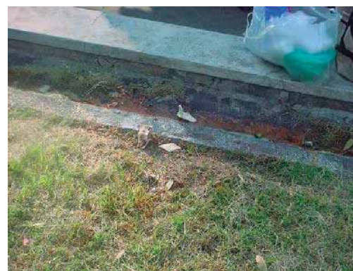
Bajadas de agua bloqueadas de basura.
