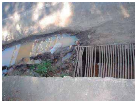
Alcantarillado en malas condiciones.
