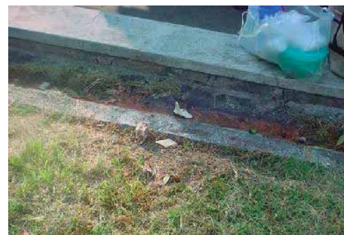
Basura en bajadas de agua pluvial.
