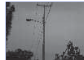
ALTA Y BAJA TENSION
