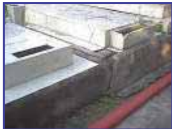
Tumbas en mal estado.
