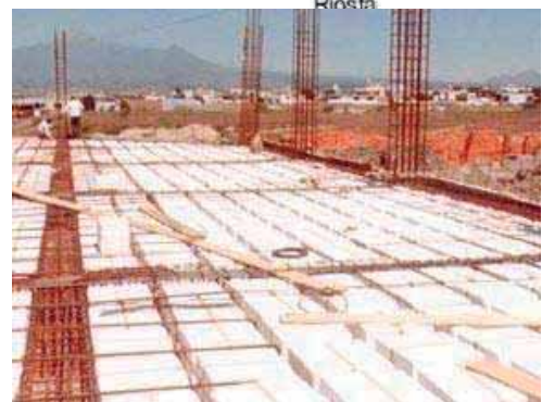
033.- En estas dos ilustraciones se puede observar la forma de como se construye una losa reticular
