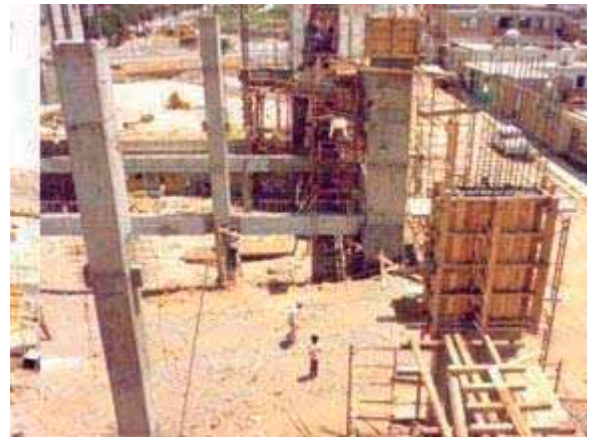
032.- en esta fotografía se muestra el proceso de cómo se construyó un inmueble, del cual nos sirve para observar que primero se desplantan las columnas y se cuelan para posteriormente levantar los muros.
