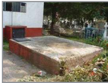
Cisterna para abastecer el núcleo de sanitarios del área poniente.
