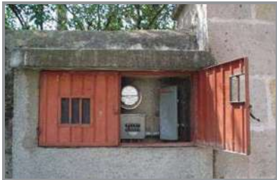
Medidor y tablero de control. En la puerta sur del panteón
