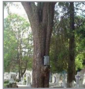
Caja de cuchillas para reflectores sobre árboles.
