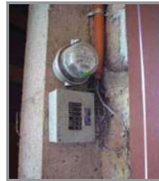
Medidor y tablero de control En la puerta norte del panteón.
