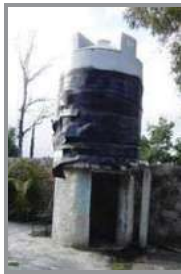
Cisterna elevada junto a la barda perimetral sureste que es llenada con pipa.
