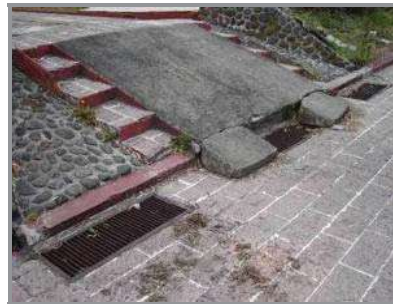
Coladeras para aguas pluviales en el área de anexo
