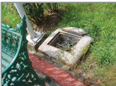
Registro de instalación eléctrica espacio de la Rotonda de los Hombres Ilustres.
