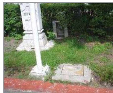
Registro de instalación eléctrica en la Rotonda de los Hombres Ilustres, y caja de control
