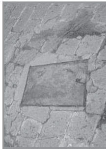
Registro de aguas pluviales en el área de anexo
