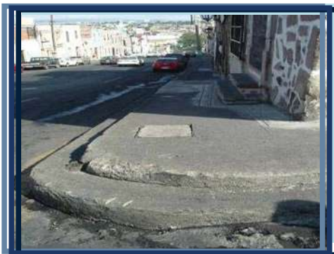
Imagen N°09 Área de circulación en mal estado
