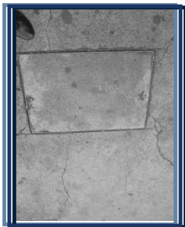
Imagen N°05 Tapa de registro de agua potable en mal estado.
