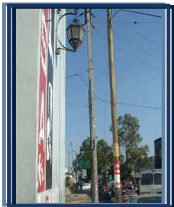
Imagen N°07 Luminaria en mal estado
