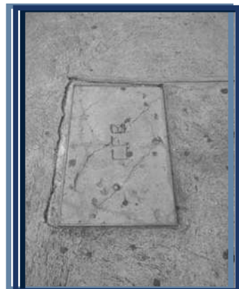
Imagen N°08 Tapa de registro en mal estado
