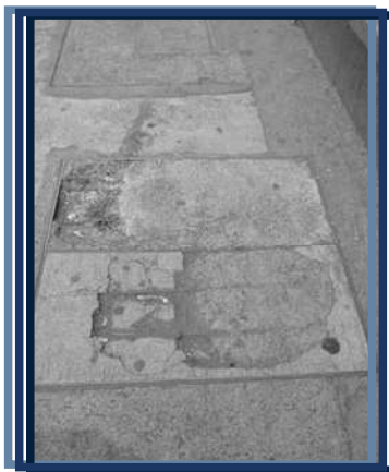
Imagen N°06 Tapa de registro de drenaje en mal estado.
