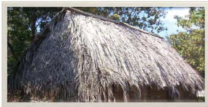
Figura 61. Muestra la cubierta de hojas de palma, la cual actúa como miles de micro burbujas creando bolsas de aire que funcionan como aislante térmico logrando que al calor le tome mucho más tiempo penetrar en la vivienda. Fotografía: Luís Torres Garibay
