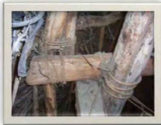
Figura 33. Muestra el acomodo de la estructura de la casa y sus materiales originales. Fotografía: Luís Torres Garibay.
