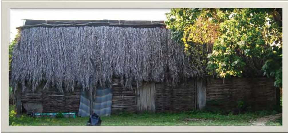
Figura 36. Muestra su integración con el entorno y el deterioro del predio. Fotografía: Luís Torres Garibay.
