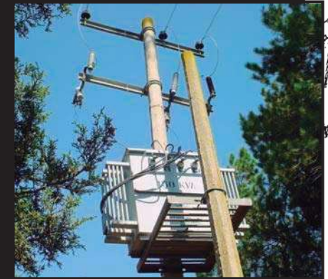
Imagen 68. Electrificación existente. ARDUM.
