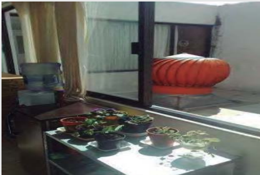
FIG 13 ..Extractor de aire colocado en una casa, foto tomada por Israel Eduardo Rosales López
