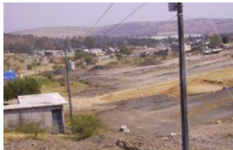
Línea de media tensión aérea
