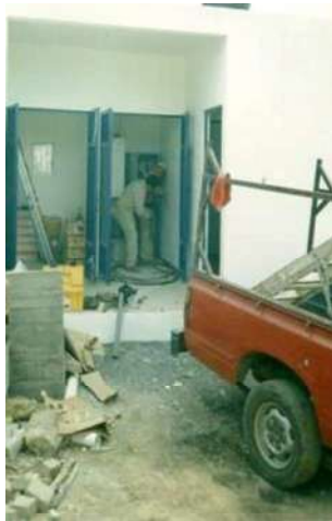
Equipamiento de Pozo
