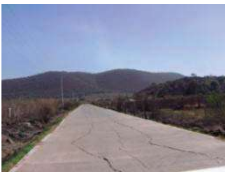
Imagen 26. Vialidad de concreto en mal estado ubicada en la Localidad de San Juan.
