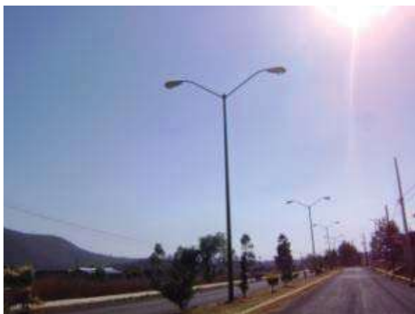
Imagen 21. Alumbrado Público Camellón de la calle López Rayón, al Suroeste de Villa Morelos.
