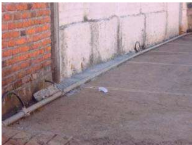
Imagen 16. Tubería de acero galvanizado de 3" en la localidad de Villa Morelos.
