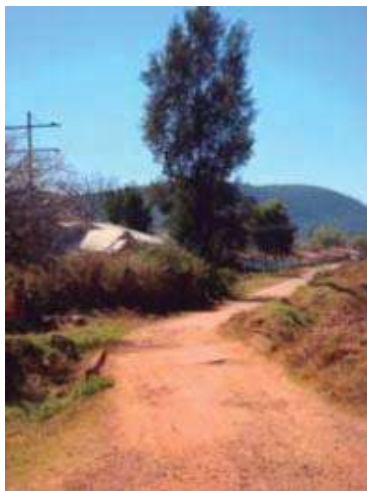
Imagen 24. Vialidad sin ningún recubrimiento ubicada en la localidad de la Noria.
