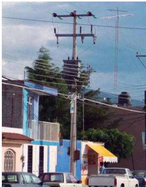
IMAGEN 15 SERVICIOS DE ELECTRIFICACION
