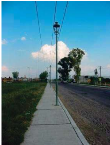
000- Alumbrado público localizado en el terreno Fotografía: Archivo personal
