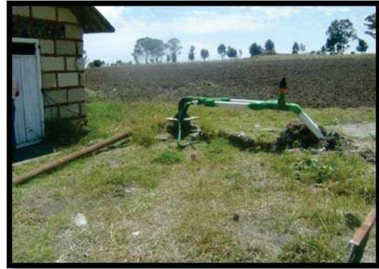
Foto 14.- Tomada el 26 de Enero del 2010. Del terreno, sobre la carretera Maravatío Acambaro, por (R.H.JR) Se observa la tubería del pozo que existe en el terreno, para el abastecimiento de la central de abasto.
