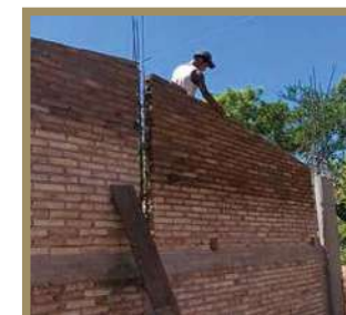
Fig. 84 Tabique rojo en muros.
