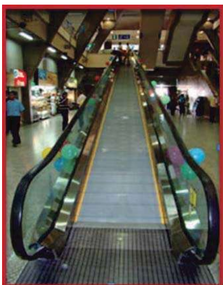
Figura no. 25 Rampa eléctrica
