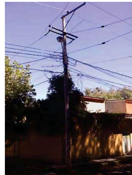
FOTO 17: vista del servicio de luz eléctrica, en la calle secundaria
