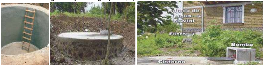
Fig. 115 Bajada de agua pluvial, aljibe de ferrocemento, Filtro y bomba
