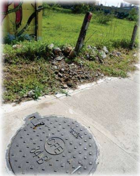
Registro de Red Eléctrica Subterránea. Foto 56
