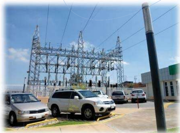
Sub estación eléctrica de la CFE escasos metros del Terreno. Foto 54
