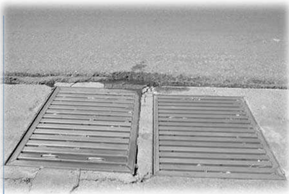
Alcantarillado afuera del Terreno. Foto 55
