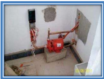
INSTALACION ELECTRICA PARA BOMBA
