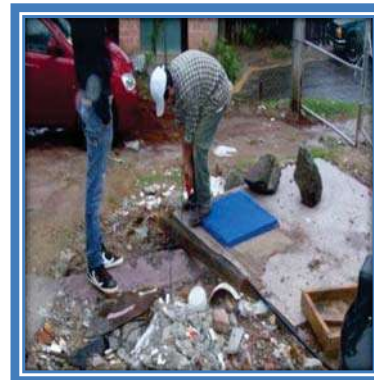
TAPA DE CISTERNA
