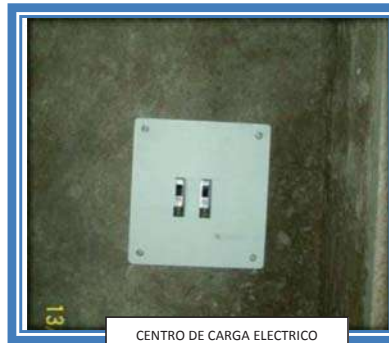
CENTRO DE CARGA ELECTRICO
