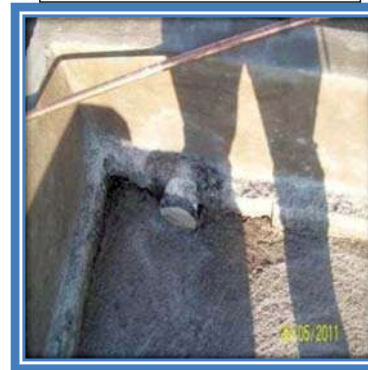
COLADERA EN BAJADA DE AGUA PLUVIAL
