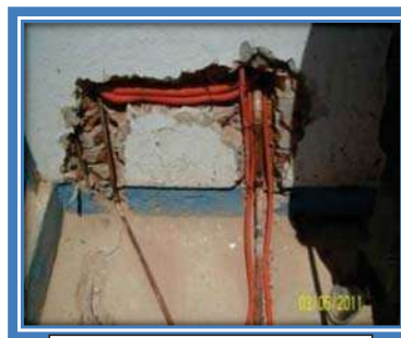
INSTALACION ELECTRICA PARA BOMBA
