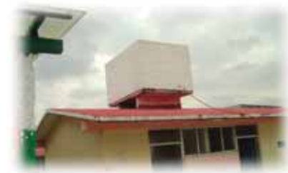
Foto 21. Tinaco para el almacenamiento de agua potable
