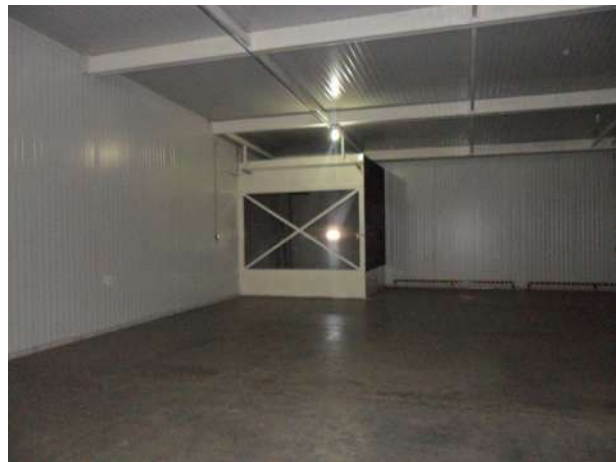
Cámaras de refrigeración
