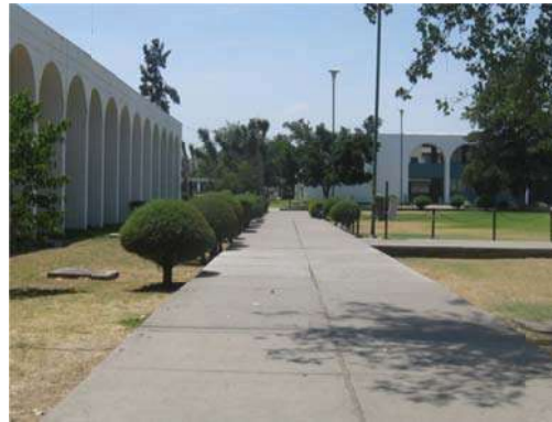
Fotografía 9. Estado actual del pasillo sin techo de la primera etapa de construcción de la Ciudad Universitaria. Fotografía de Zintly Linares.
