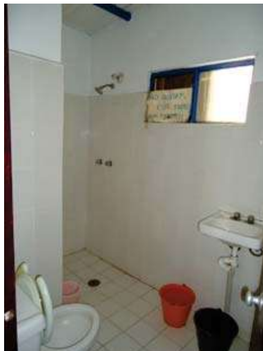
Ilustración 22. Baño. Clínica Turicato. Totalmente inadecuado, ya que es el único y funciona tanto para servicio al público, médicos y residentes, hombres y mujeres. Foto V.T. tomada por Víctor A. Guillén García.
