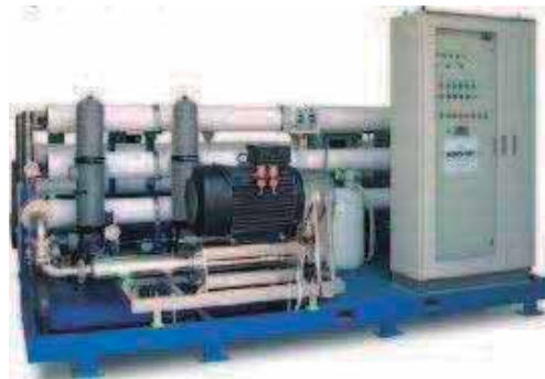
FOTO 90 Planta de osmosis inversa 240m3 por jornada de 24 hrs. http://www.solostocks.com
