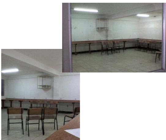
Imagen 2.7.10 Aquí se muestra el interior de la sala que albergara a la Universidad Industrial nótese el deterioro que tiene, y la falta de espacio para lo que será destinada.
