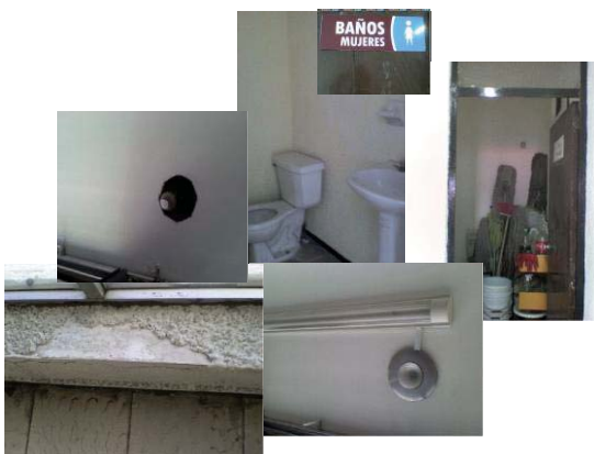
Imagen 2.7.14 en esta ilustración se muestra lo obsoleto y deteriorado que están tanto las instalaciones como las áreas de mantenimiento
