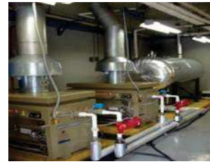
Figura No. 36 Cuarto de máquinas y calderas.
