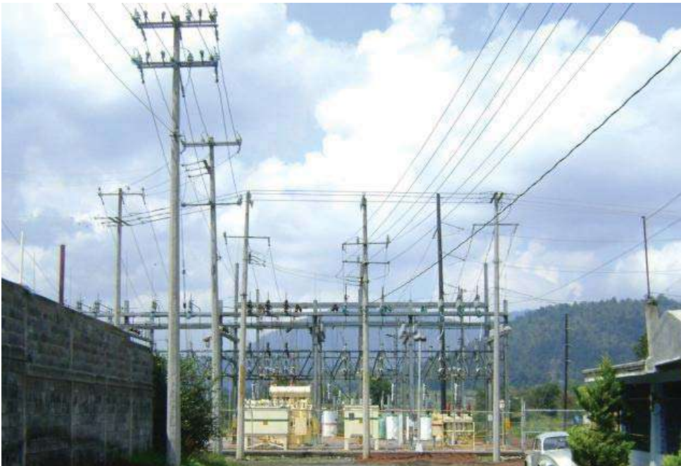
Imagen 28.-Subestación eléctrica, Menchaca D 55 .
