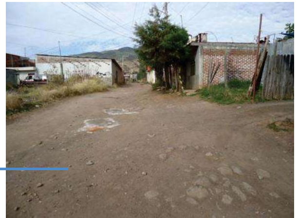
Figura 45.- El problema de las calles sin pavimentar aumenta especialmente en época de lluvias generando problemas de tránsito peatonal. Foto: Roberto Alvarez. Enero 2012.
