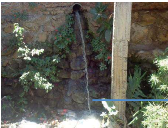
Figura 41.- La red de drenaje desemboca en los ríos, causando graves problemas sanitarios y de impacto ambiental. Foto: Roberto Alvarez. Febrero 2012.
