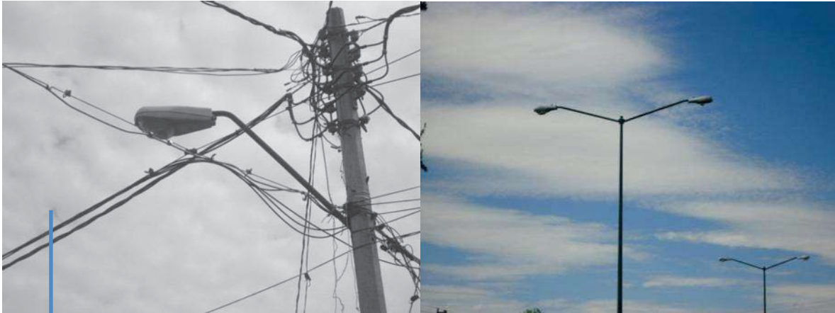
Figura 43.- Los cables de energía eléctrica dan mala imagen a la ciudad (Imagen Izquierda). Otro tipo de luminaria que podemos encontrar son arbotantes como las que se encuentran en la Calzada San Juan. Foto: Roberto Alvarez. Febrero 2012.
