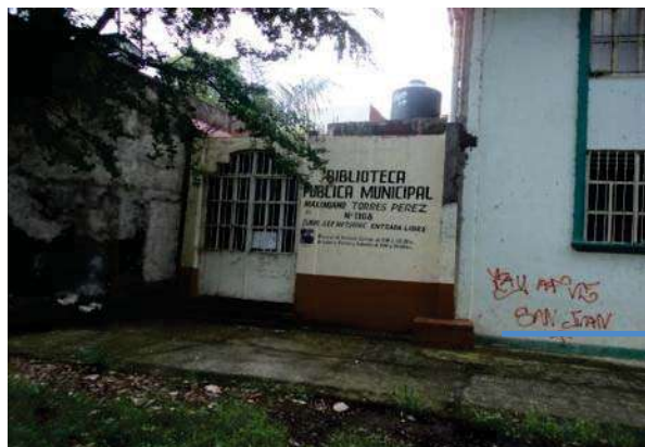
Figura 49.- En la Imagen se puede observar el mal estado en que se encuentran las instalaciones de la Biblioteca Pública Municipal Maximiano Torres. Los Reyes. Foto: Roberto Alvarez. Noviembre 2011.
