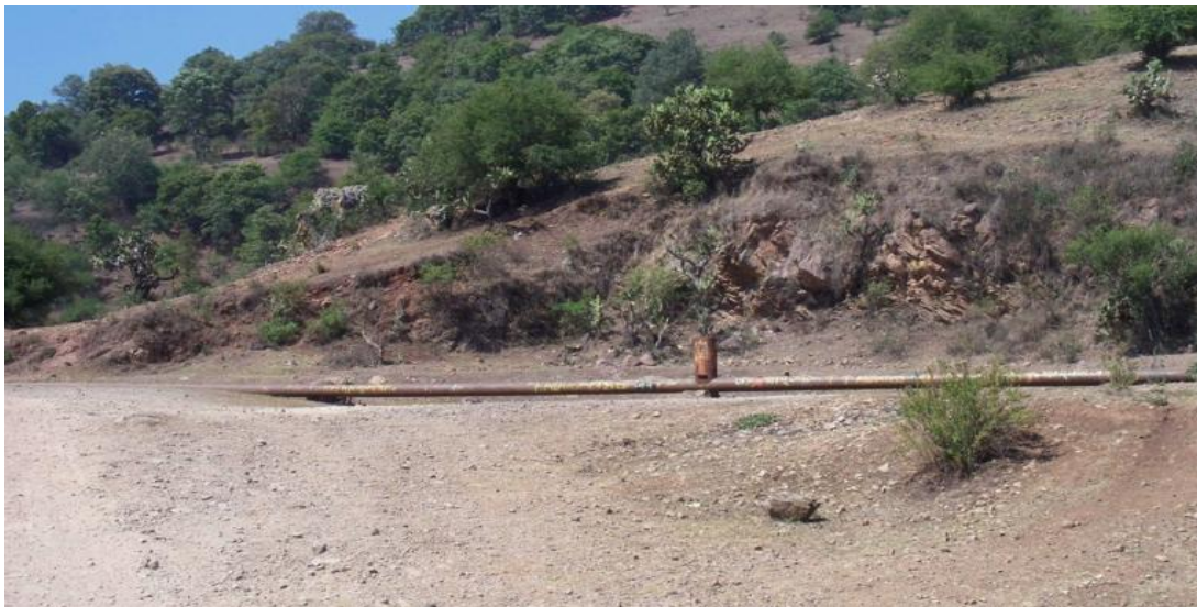
Fig. 3.16 Tubería de agua Potable. Fuente: Autor
