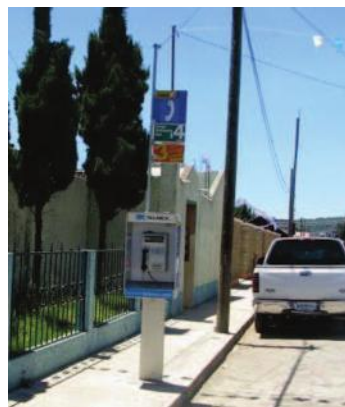
Imagen N°52 teléfono público tipo 2
