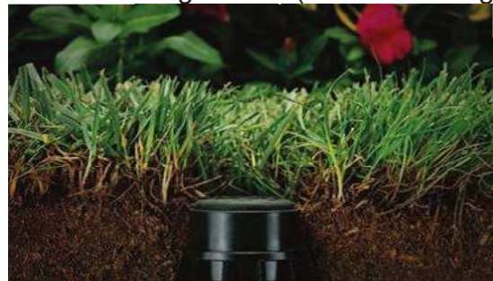
Imagen N°36(sistema de riego)
