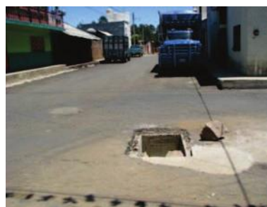
Imagen N°69 tapa de drenaje en malas condiciones
