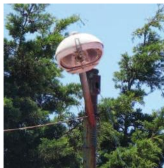
Foto N°77 Lámpara en mal estado
