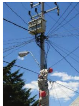
Foto N°72 mantenimiento a transformador
