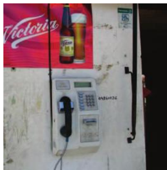
Imagen N°51 teléfono público tipo 1
